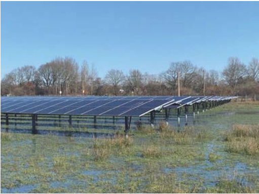
Abb. 6. Photovoltaikanlage auf einer Moorfläche in Schleswig-Holstein. – Foto: Bas Spanjers, ARGE KlimaMoor.
